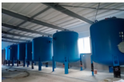
Stacja Uzdatniania Wody w Młynarach
